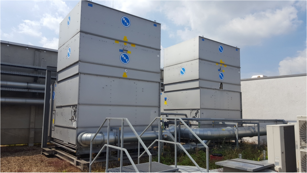
Kühltürme zur Kühlung von Turbo-Kälteanlagen
