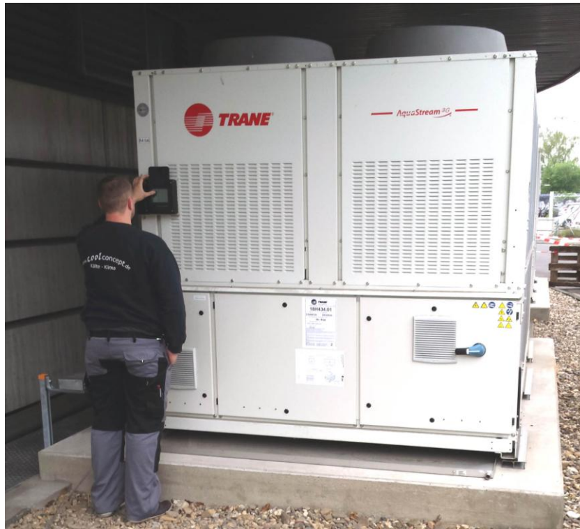
Luftgekühlter Chiller 450kW in Köln
