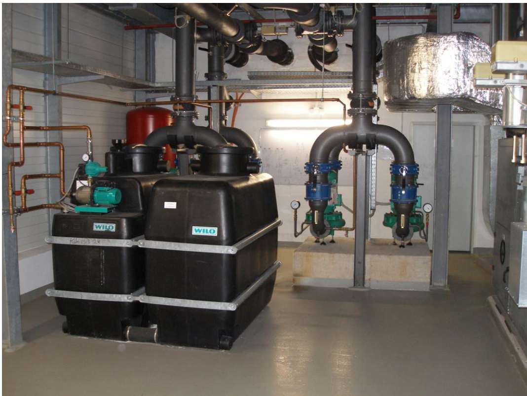
Kühlwasserspeicher und WILO Pumpenpark
