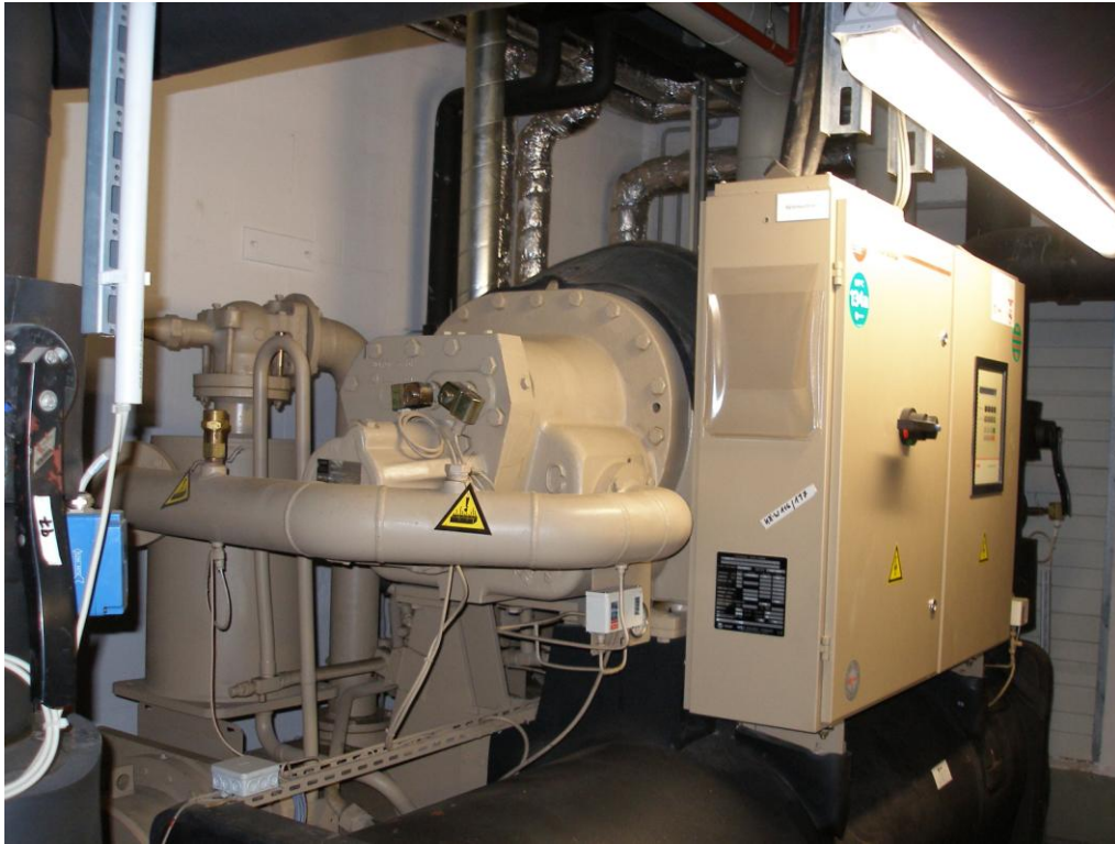
2x 800kW Schraubenverdichter zu Klimatisierung eine EKZ und Kino in Solingen
