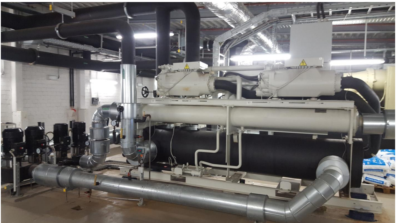
Kaltwassererzeuger 2x 250kW
