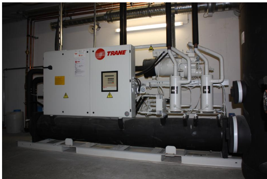
2x 220KW Schraubenverdichter zur Klimatisierung eines EKZ in Heiligenhaus
