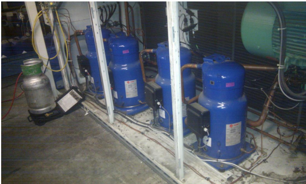
Chiller zur Innenaufstellung 280kW in Solingen
