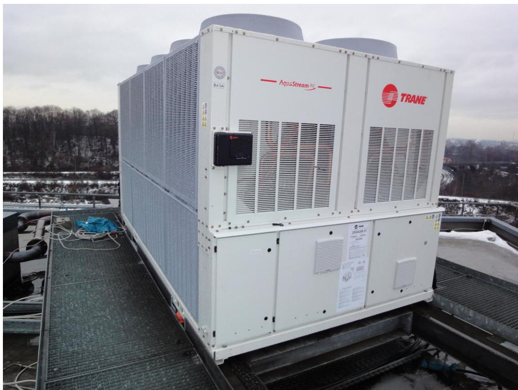
Luftgekühlter Chiller 600kW in Aachen
