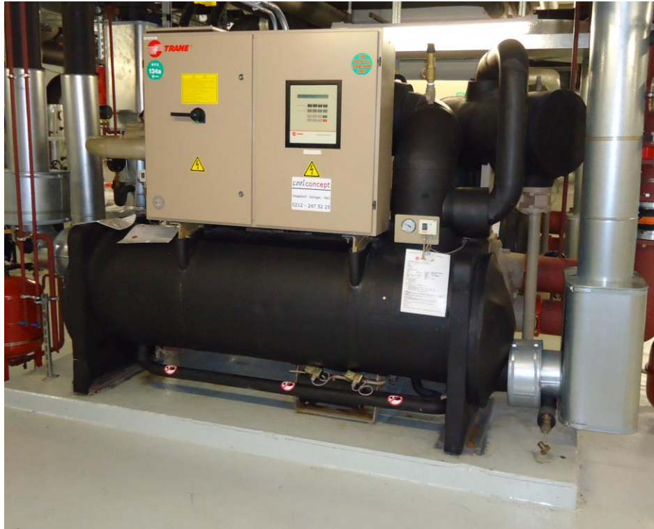
Wassergekühlter Schraubenverdichter 900kW in Bonn
